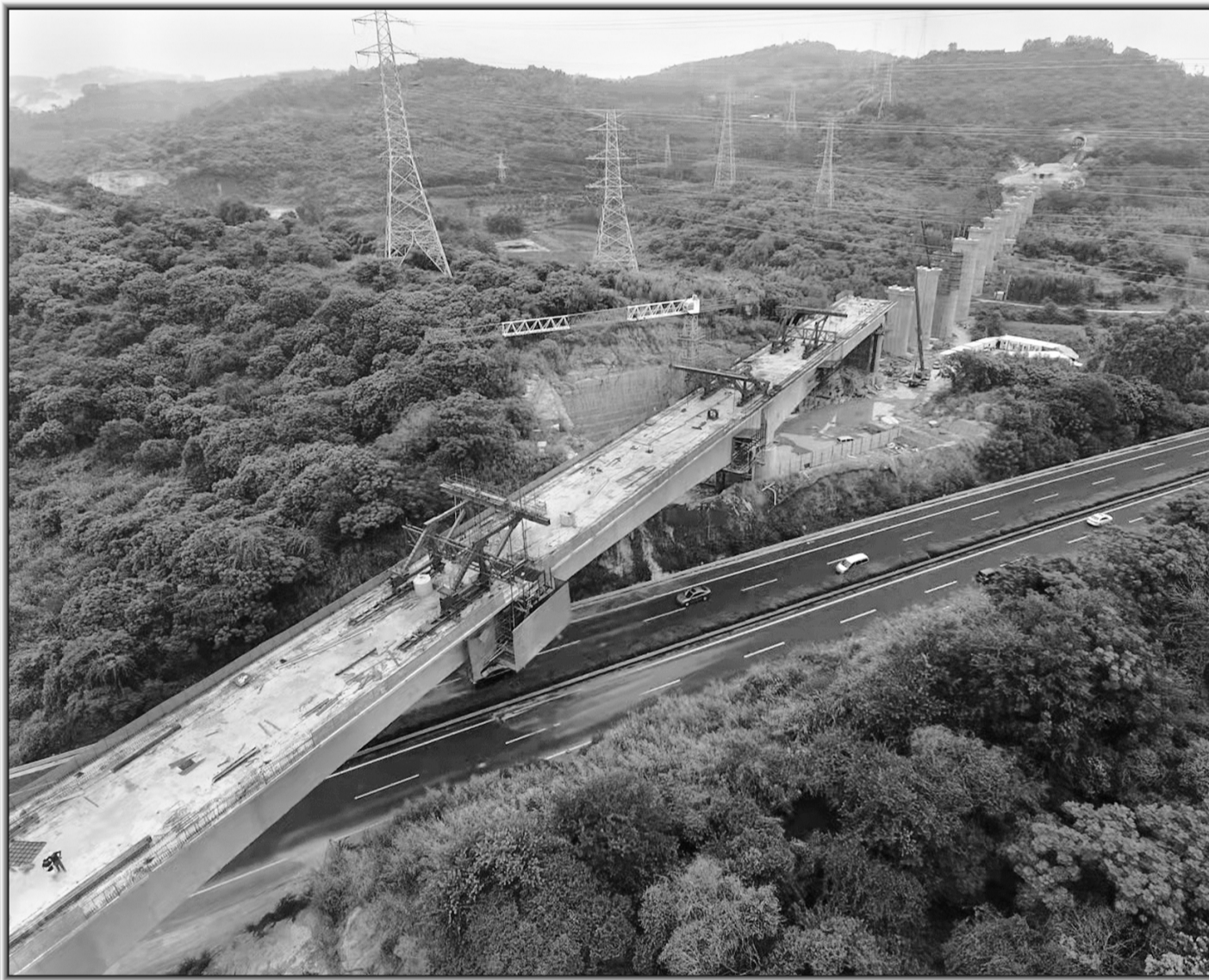
9月2日，随着最后一车混凝土浇筑入槽，由路桥公司福厦项目部承建的福厦铁路九龙江特大桥跨沈海高速连续梁合龙。
